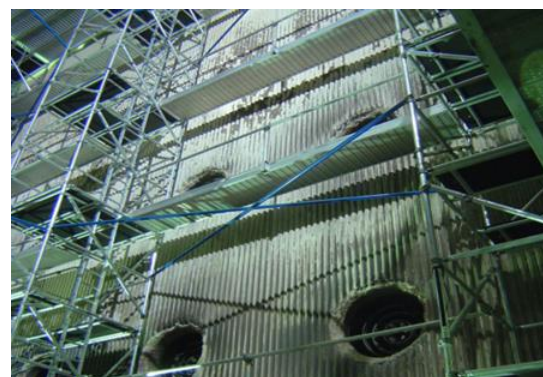
▶ ボイラー内部
